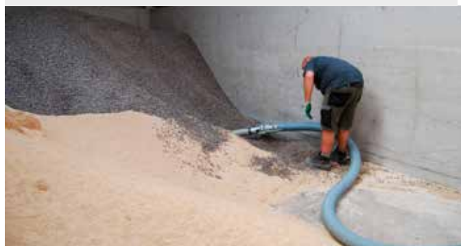
Comme l'installation est mobile et assez compacte, les différentes matières premières peuvent être aspirées facilement dans les différents silos. ■
