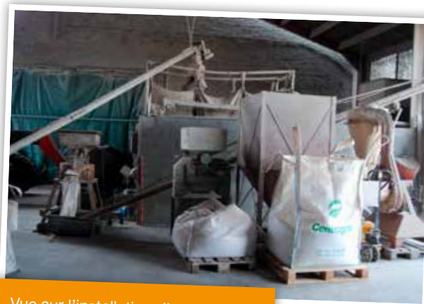
Vue sur l'installation d'aplatissage.
