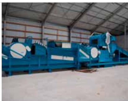
Zicht op één van de drie verwerkingslijnen van de nieuwe fabriek die eind september in gebruik wordt genomen.
