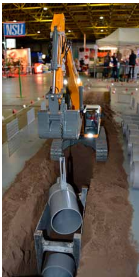
Ze schuwen ook het fijne aannemingswerk niet. Hier de Liebherr 944 aan het werk.
