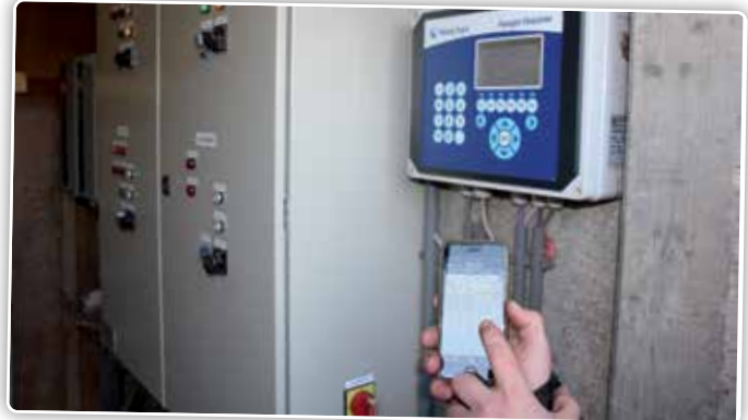
In 2007 bouwde de familie een nieuwe aardappelopslag met een Mooy Agro koelings- en ventilatiesysteem met frequentieregelaar. Het systeem is eveneens volledig aan te sturen via een app.
